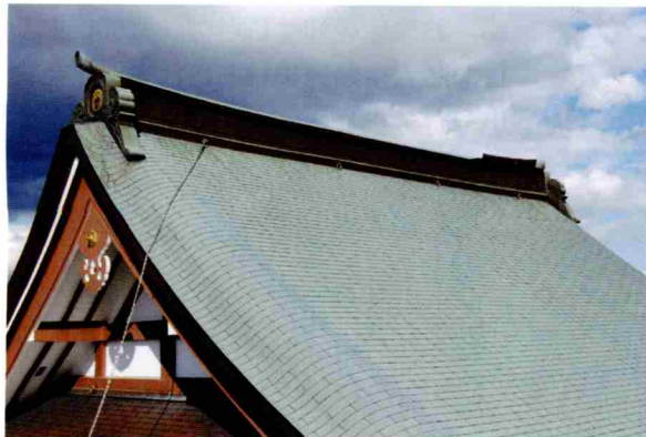
本堂の箱棟破損（台風）
